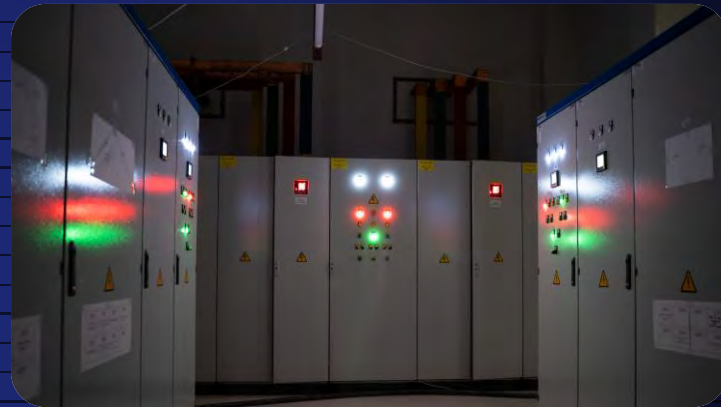
Главный распределительный щит
