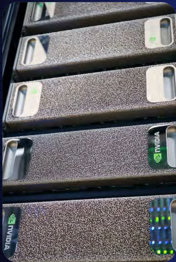
Суперкомпьютер «Говорун» (GPU компонента на воздушном охлаждении 2018 г.)
