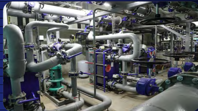
Охлаждение зала МИВК (-1 этаж здания ЛИТ)
