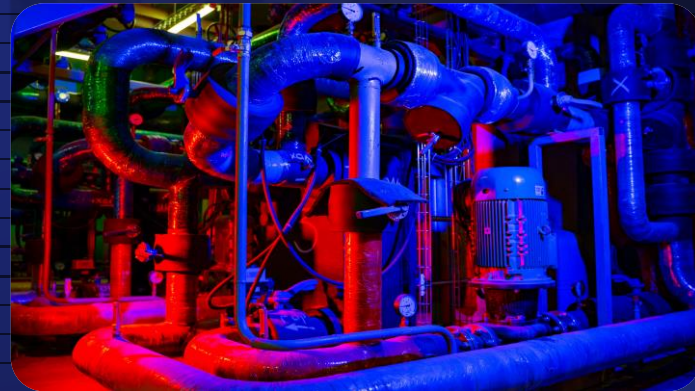
Насос и теплообменник сухой градирни
