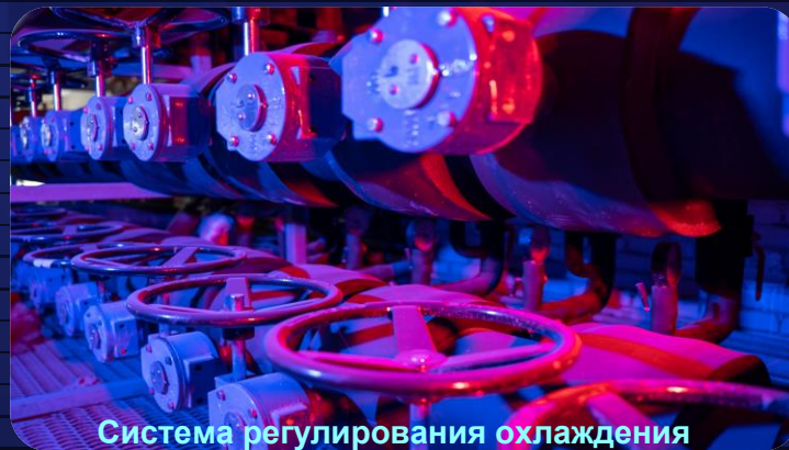
Система подачи охлажденной воды в межрядные кондиционеры
