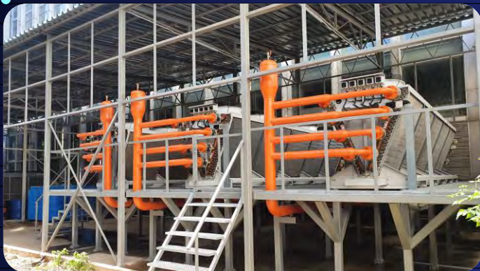
Сухие градирни системы охлаждения МИВК
